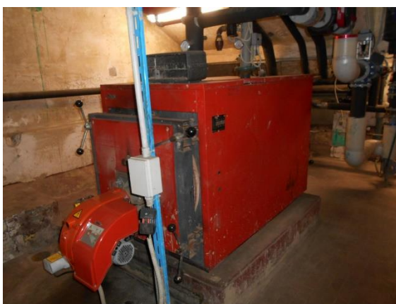
Figura 4.11 - Particolare della caldaia
