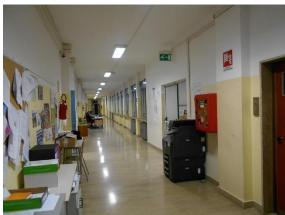
Figura 4.14 - Particolare dei corpi illuminanti ubicati in un corridoio
