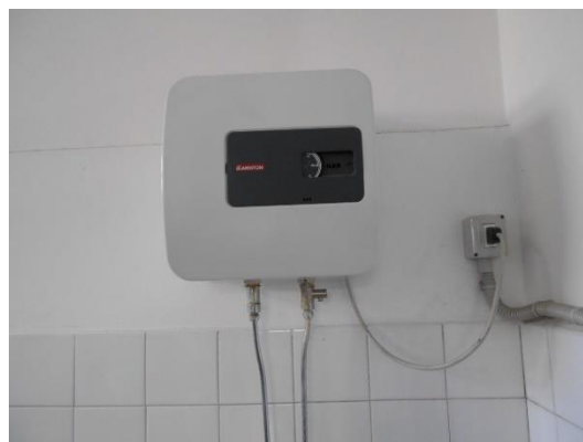
Figura 4.12 - Particolare di un boiler elettrico per la produzione di acqua calda sanitaria
