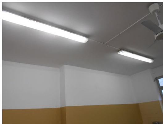
Figura 8.10 - Particolare di una plafoniera a tubi fluorescenti
