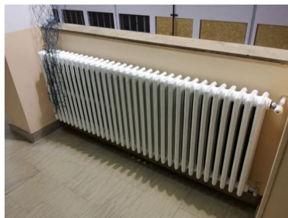
Figura 4.8 - Particolare di un radiatore in ghisa
