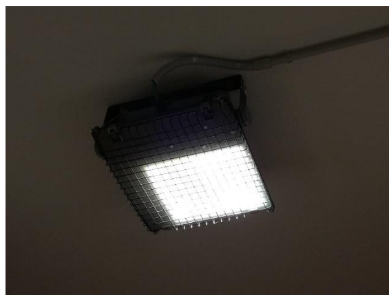
Figura 4.15 - Particolare dei fari ubicati nella palestra
