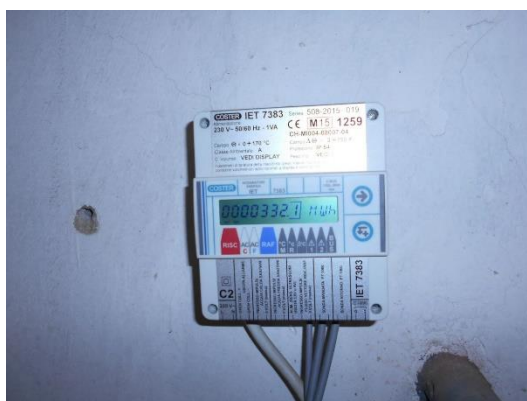
Figura 4.9 - Particolare della centralina di controllo dell’edificio
