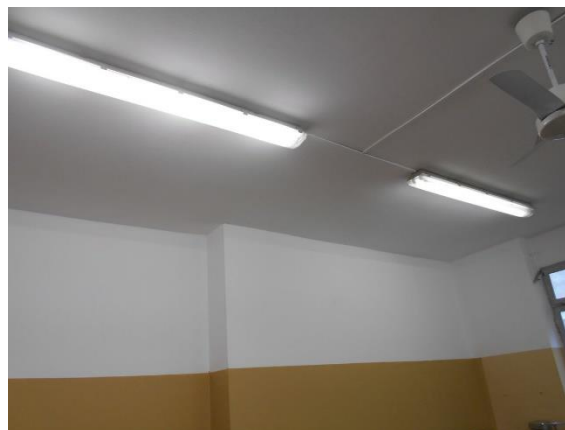
Figura 4.13 - Particolare dei corpi illuminanti ubicati nelle aule scolastiche
